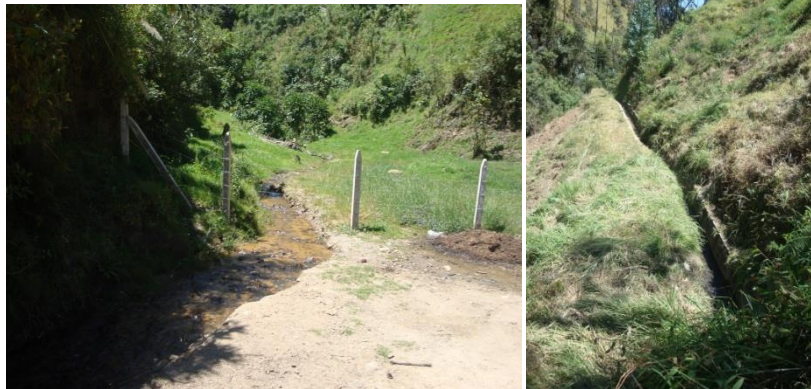
FOTOGRAFÍA NRO. 36 INFRAESTRUCTURA DE CANAL DE RIEGO GONZÁLEZ RODRÍGUEZ: CAPTACIÓN-REVESTIMIENTO.
