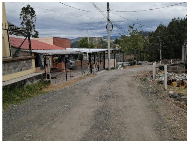
FOTOGRAFÍA NRO. 41 VÍA DE BUIL CHACAPAMBA DE LASTRE EN MAL ESTADO
