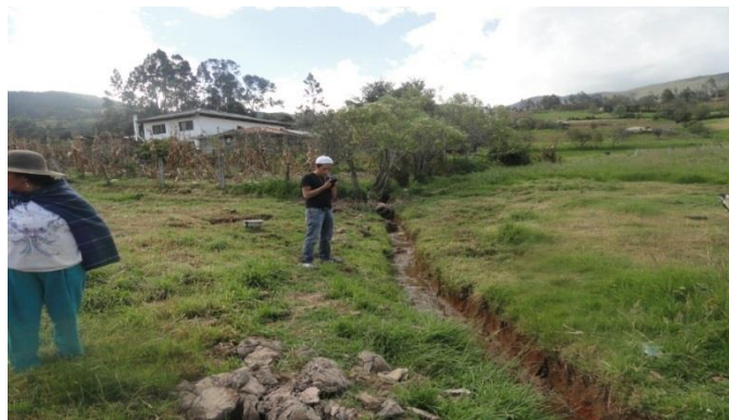
FOTOGRAFÍA NRO. 17 CANAL DE AGUA EN LA PARTE ALTA DEL DESLIZAMIENTO QUE PUEDE SER LA CAUSA DE ESTE MOVIMIENTO FUENTE: EQUIPO CONSULTOR ELABORADO POR: EQUIPO CONSULTOR
