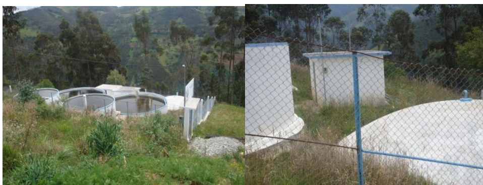
FOTOGRAFÍA NRO. 29 JUNTA ADMINISTRADORA DE AGUA POTABLE FISE DE GUINDILIG: FILTROS DE ARENA-CASETA DE CLORACIÓN FUENTE: EQUIPO CONSULTOR
