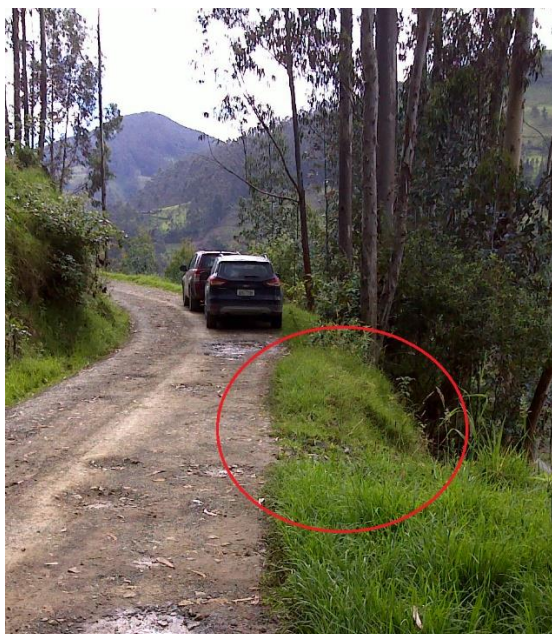
FOTOGRAFÍA NRO. 26 PERDIDA DE LA MESA DE LA VIA
